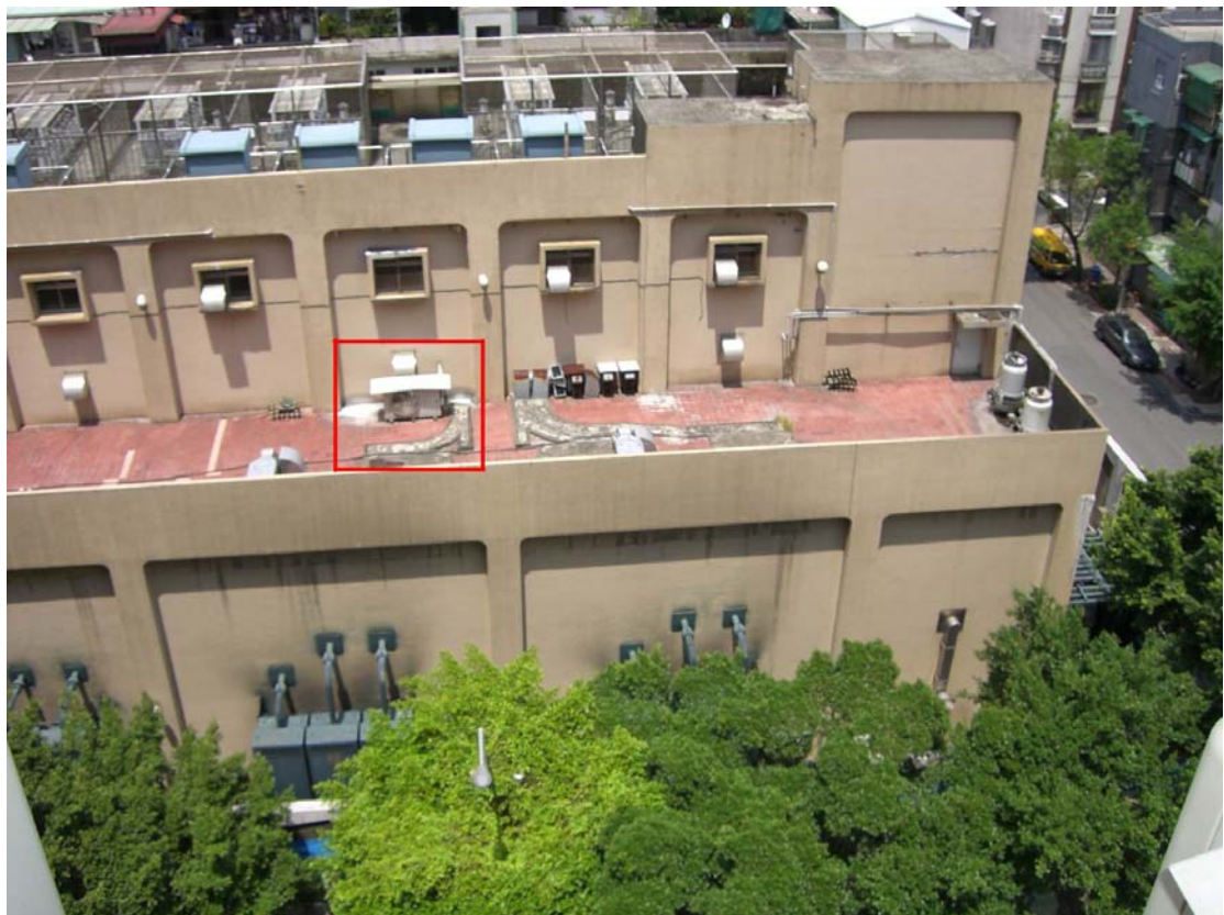
延壽街 319 號變電所 2 樓空調位置照片
