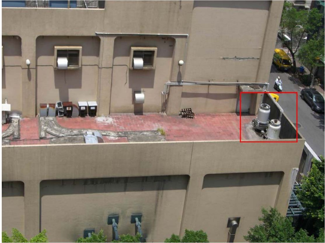
延壽街 319 號變電所 2 樓空調冷卻水塔位置照片
