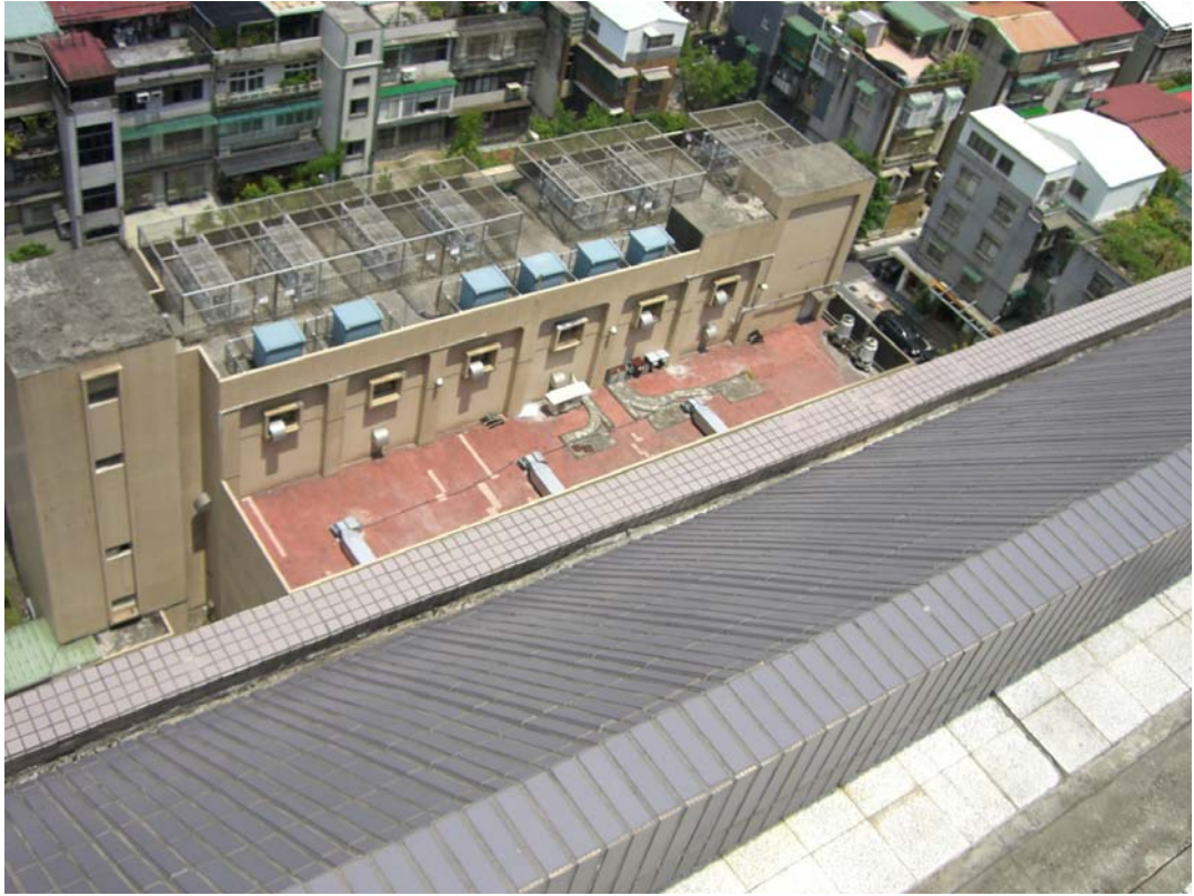
延壽街 319 號變電所位置照片(一)
